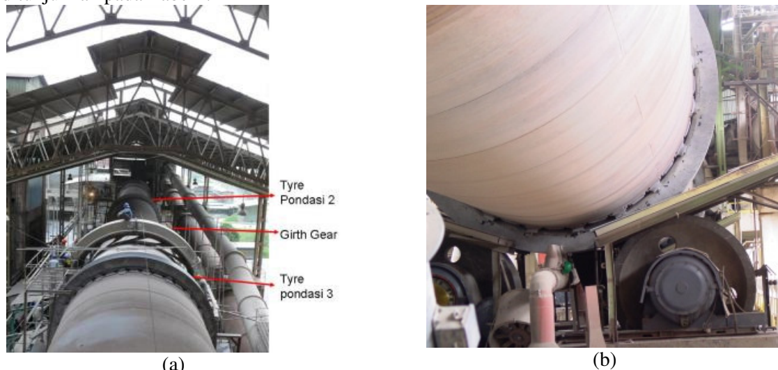
(a) Gambar 4 a. Tyre atau live ring pada kiln Indarung V PTSP (b) b. Supporting roller
