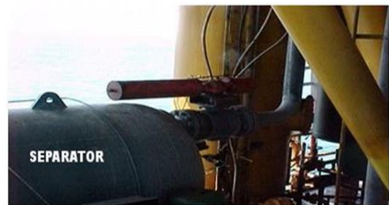
Gambar 1. Unit separator di instalasi lepas pantai Kepulauan seribu (CNOOC)
