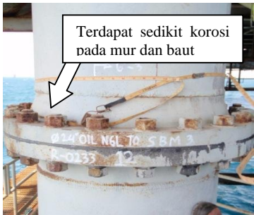
Gambar 14 Tampak dekat kondisi flange, baut, dan mur [8]
