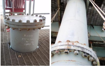
Gambar 13 Kondisi break spool Line A [8]
