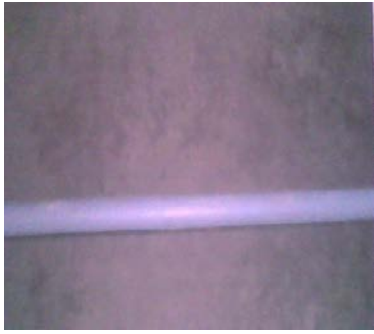
Gambar 2. Pipa Pemasukan (Pipa PVC)
