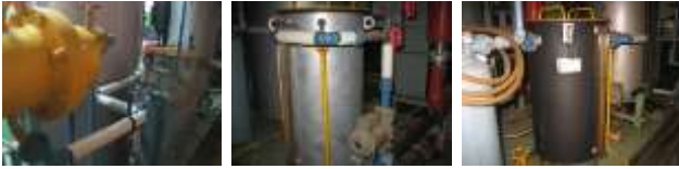
Gambar 11. Beberapa Isolator Yang Terpasang Di Jalur Pemipaan Condenser Hingga Feed Water Tank
