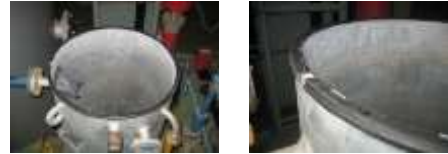
Gambar 7. Seal Karet Pada Condensate Tank
