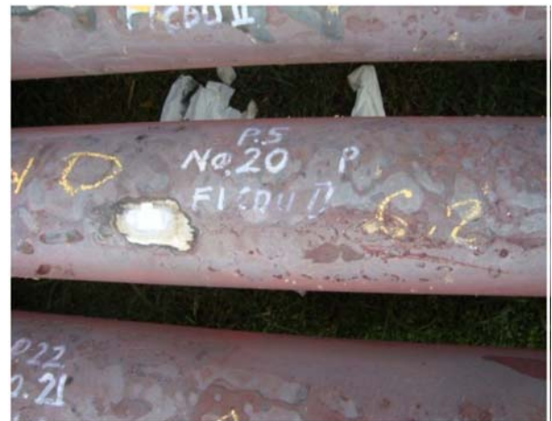
Gambar 2. Pipa furnace saat pemeriksaan visual (diambil pada Senin, 25 November 2013).
