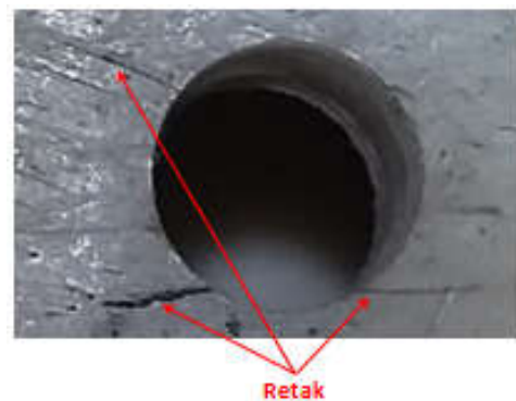
Gambar 4. Retak yang Timbul Akibat Proses Drilling
