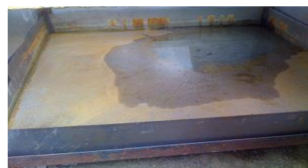
Gambar 6. Tempat penampungan air
