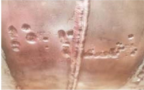
Gambar 1. Korosi di pipa
