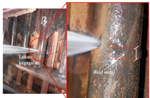
GAMBAR 1. Kebocoran pada pipa economizer
