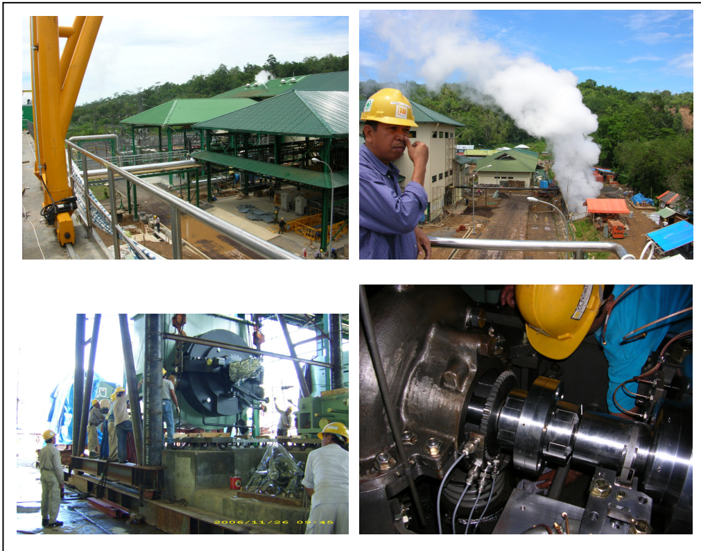
Gambar 7a. Saat instal PLTP Lahendong II 1x20 MW, operasi komersial juli 2007.
