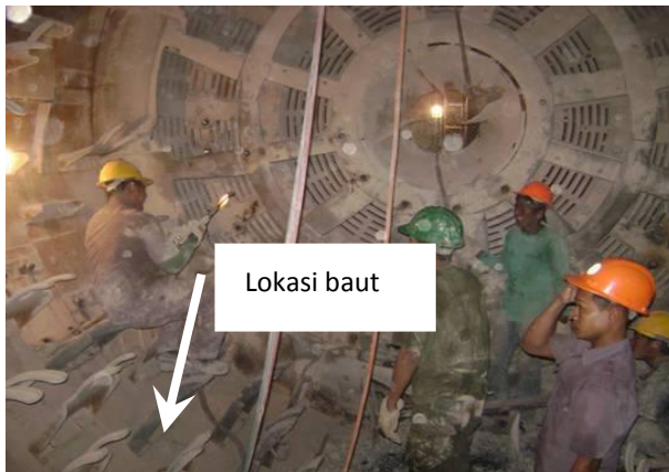
Gambar 1. Lokasi baut pengunci Diafragma Raw Mill
