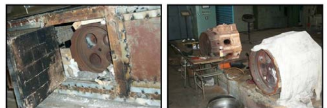
Gambar 12. Pemberian preheat di dalam tungku pemanas, sebelumnya komponen diselubungi asbestos untuk menghindari pendinginan yang terlalu cepat.
