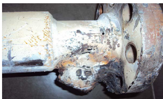
Gambar 1. Pipa stainless steel yang bocor. [Sumber: PT. PIM- Aceh Lhokseumawe]
