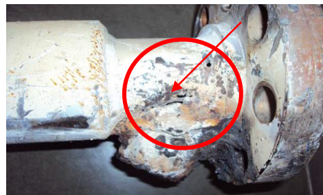
Gambar 8. Lokasi yang mengalami kebocoran sekitar lasan (ditunjukkan oleh anak panah).
