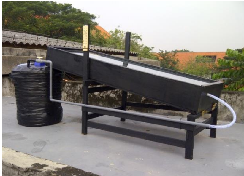
Gambar-3 Instalasi kolektor surya pemanas
