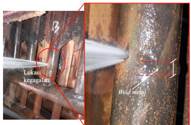
GAMBAR 1. Kebocoran pada pipa economizer
