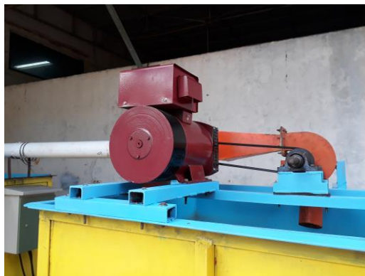
Gambar 3. Rangkaian turbin pembangkit listrik
